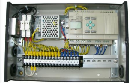
<コントロールBOX>
